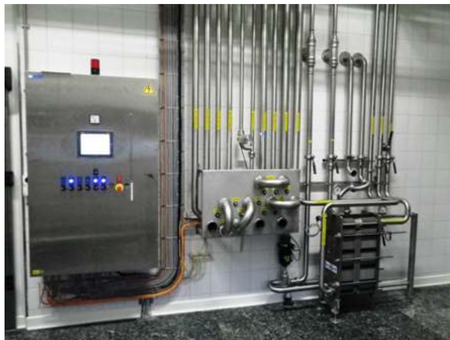
Трубопровод с панелью переключения потоков, подогреватель с функцией рекуперации тепла
