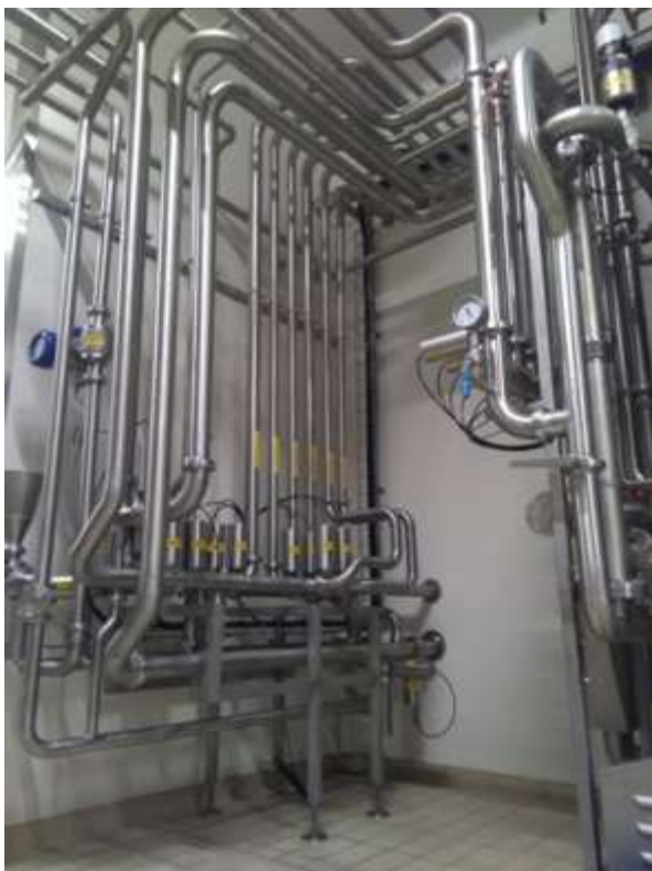
Трубопровод с поворотным дисковым затвором-автоматом
